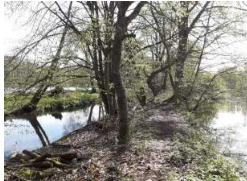
Rive droite très très dégradée
